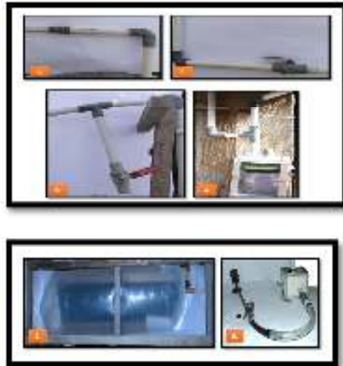
Gambar 2. Rangkaian pipa penyaluran biogas
